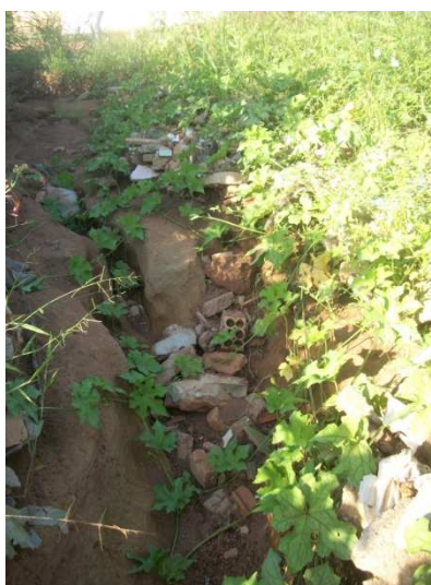
FIGURA 04: Erosão em voçorocas.
